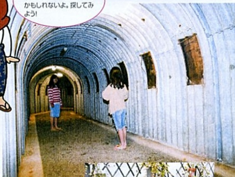
防空壕の内部。土砂が崩れ始めたので10年前に補強されました。
